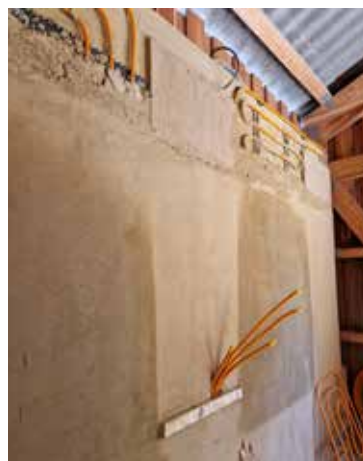
Bei Neubauten eignet sich Lehm besonders für Wandheizungssysteme.
